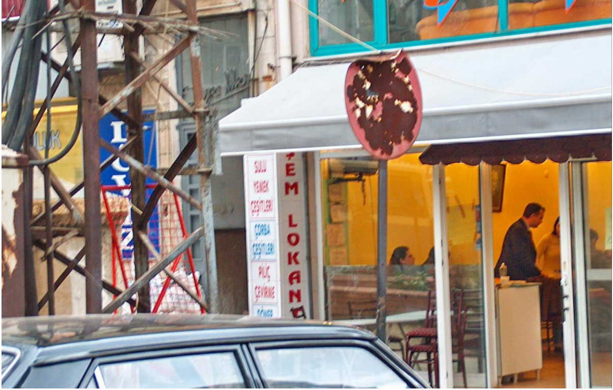
Foto-2.4.19 Trafik İşaretlemesindeki Yetersiz Bakım ve Onarım
