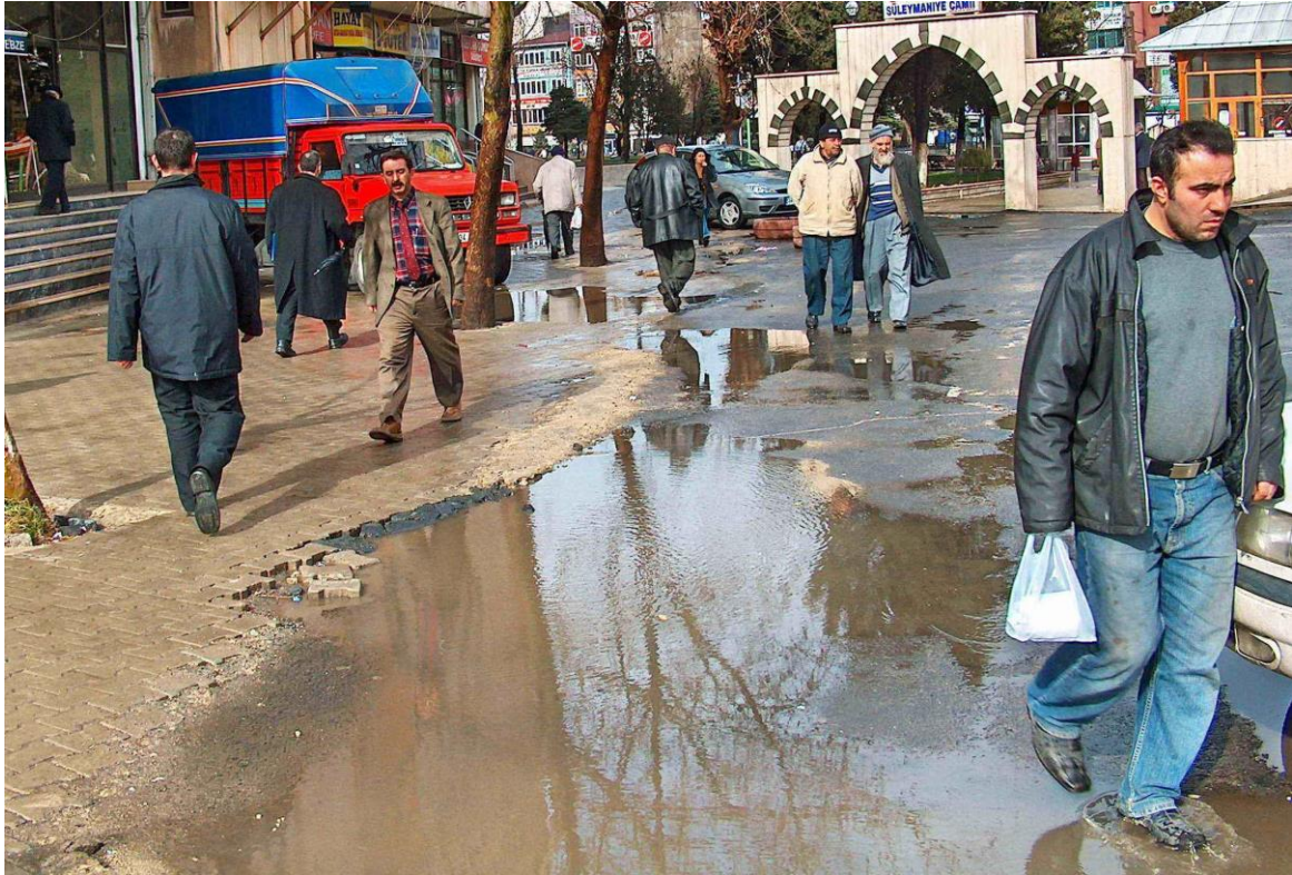
Foto-2.4.14 Belediye Yanındaki Taşıtlara Kapalı Yolda Drenaj Sorunları
